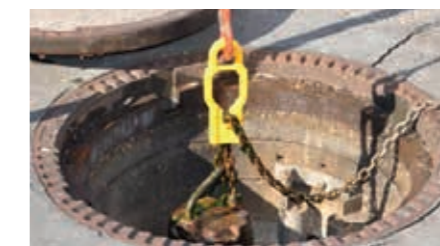
Heben von Pumpen mittels Pumpengreifstück
