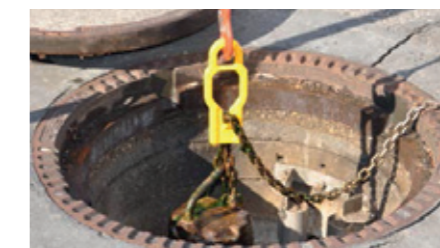
Heben von Pumpen mittels Pumpengreifstück
